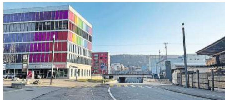
Die Unterführung Goldschlägistrasse mit ihren beiden Personendurchgängen wird erneuert. Bild: Natacha Schmassmann (17.12.2022)
